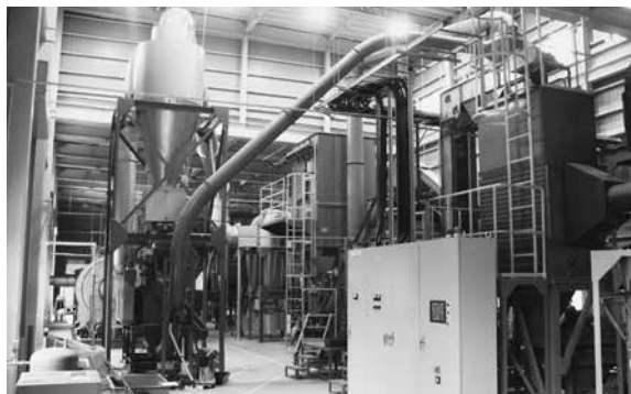
ペレットの製造設備
